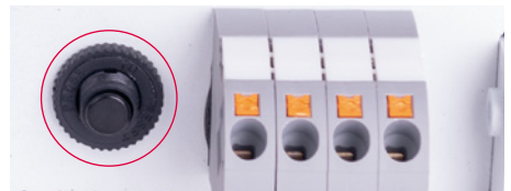
Heizkreissicherung durch Drücken zurücksetzen
